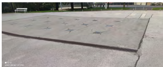
Slika 1 : razpokane asfaltne površine
