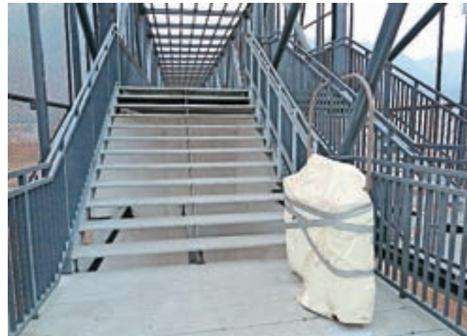
Dvizna ploščad za invalide je nefunkcionalna, zato bodo še letos zgradili klančino.
