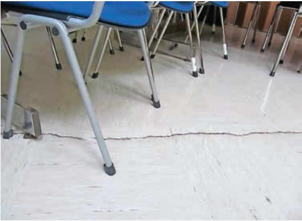
Zaradi žlindre so tla v zbornici, knjižnici in nekaterih učilnicah razpokana in dvignjena.
