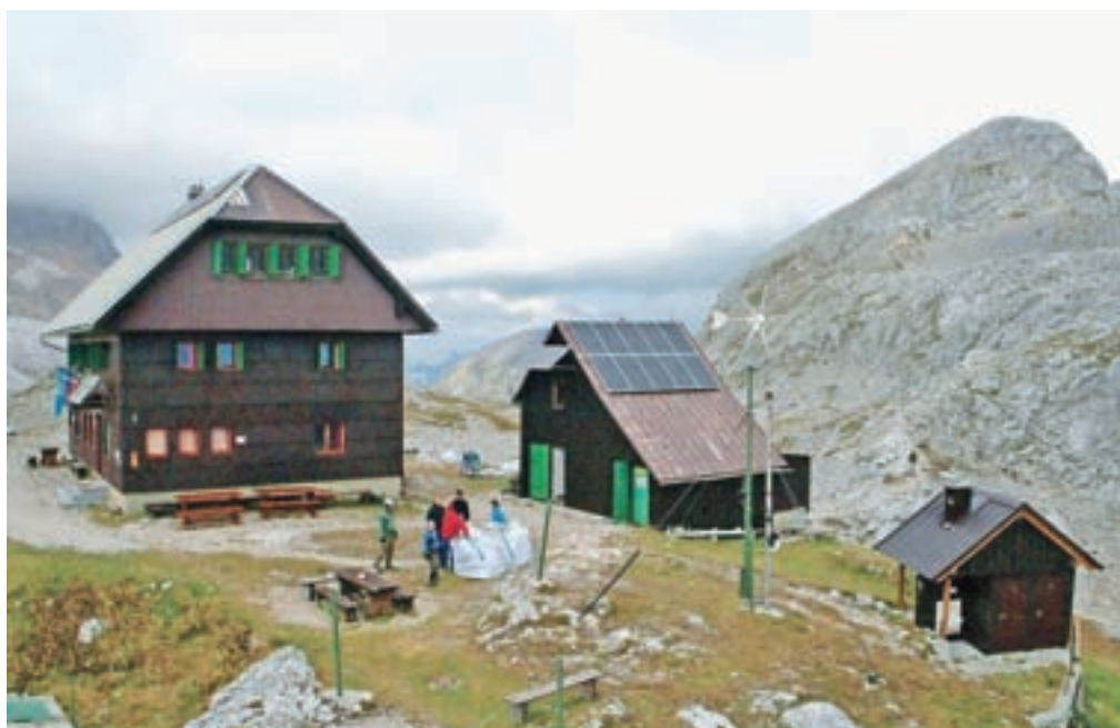
V planinski koči Dom Valentina Staniča pod Triglavom (2332 m n. m.) električni generator na fosilna goriva ni več potreben, elektriko pridobivajo z energijo sonca in vetra.
