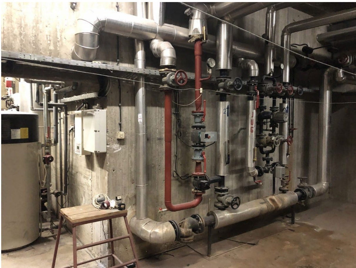
Slika 19: Kotlovnica v kleti - razdelilec
