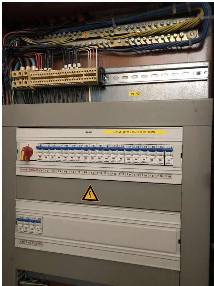
Slika 48 Slika elektro omare v nadstropju
