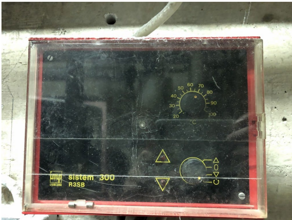
Slika 28: Star sistem regulacije ogrevanja stavbe, ki ni več v uporabi
