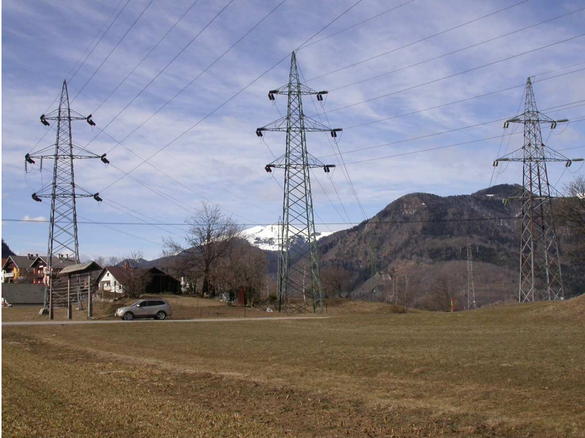
Slika 1: Tip stebrov »sod« pri daljnovodih DV 2 x 110 kV Okroglo - Jeklarna in DV 2 x 110 kV HE Moste – RTP Jesenice pri naselju Blejska Dobrava.
