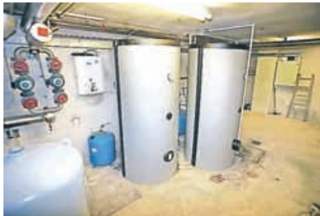
V strojnico so namestili skupni bojler za vsa stanovanja, ki ima zmogljivost dvakrat po osemsto litrov.
