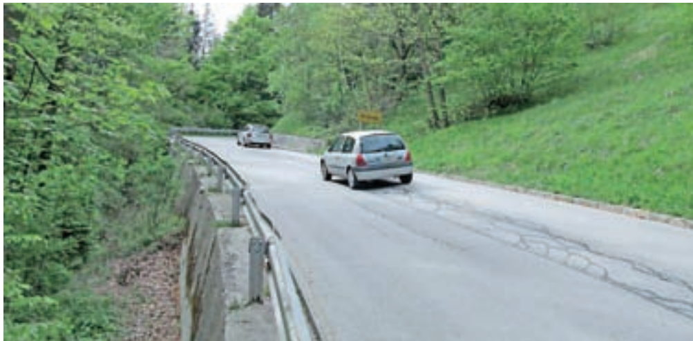
Zagotovo najtrši oreh je odsek na cesti pod naseljem Prihodi, kjer se je cestišče posedlo.
