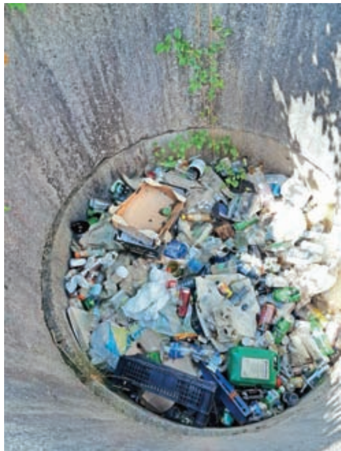
Betonsko cev, v kateri se kopičijo odpadki, naj bi zaprli oziroma odstranili.
